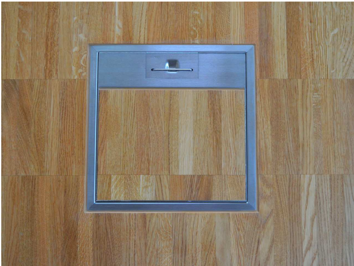
Perfektion im Detail 2: Installationsschächte mit Deckeln aus Edelstahl und Parkett im Boden.
