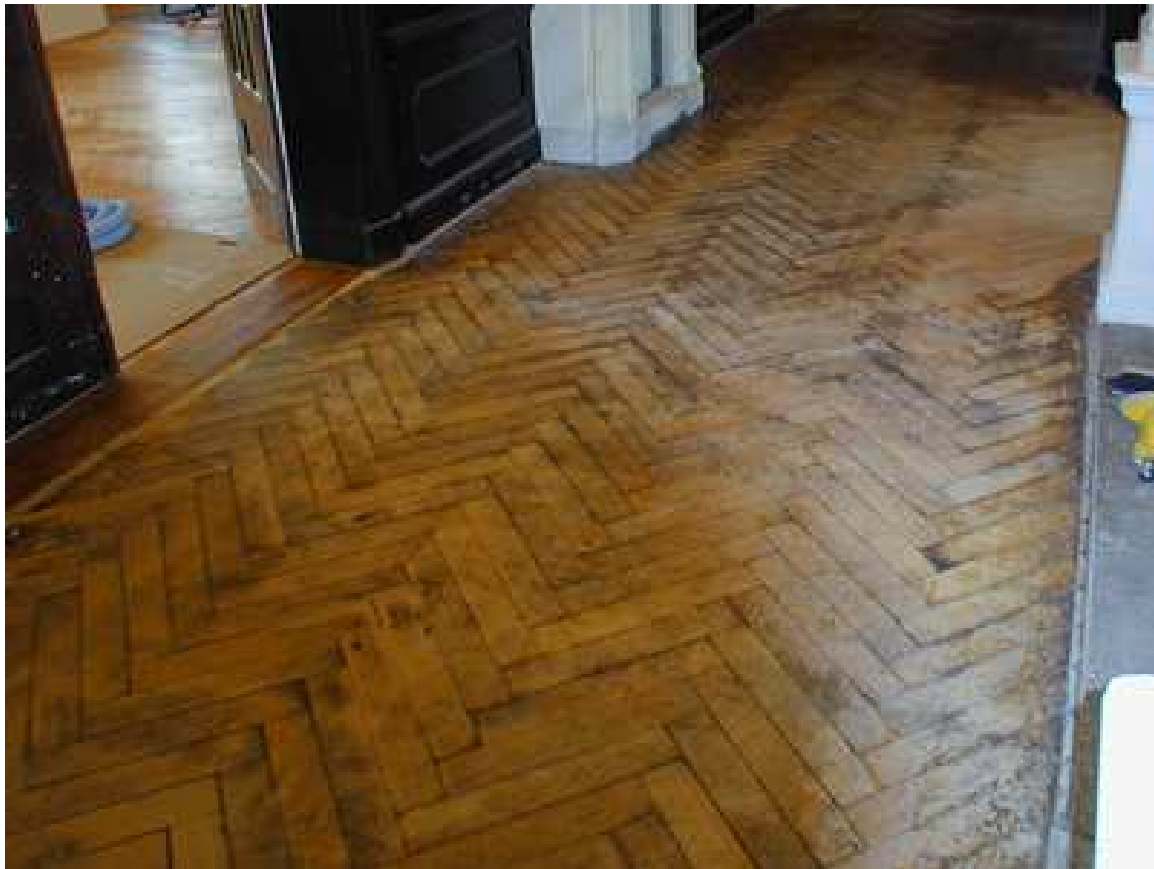
Oberflächenbild eines Schulflurs vor der Sanierung...
